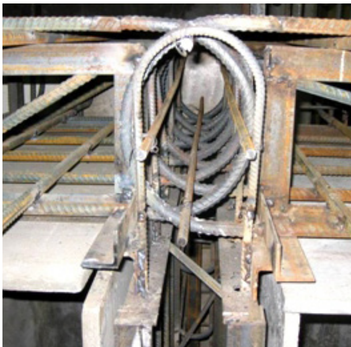
Рисунок 9 - Узел соединения армоблоков с плоскими рамами стены и перекрытия с помощью стыков Передерия
