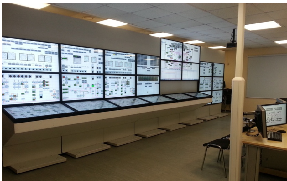
Пульт оператора виртуального энергоблока АЭС (ВЭБ).
