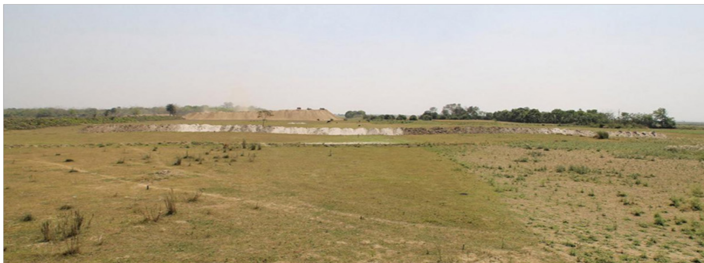
Рис. 5. Общий вид линейного понижения в рельефе, приуроченного к западной части площадки строительства. Фотография сделана в южном направлении. В ближней перспективе виден отвал траншеи № 3, на горизонте – полигон складирования грунта с площадки строительства.
