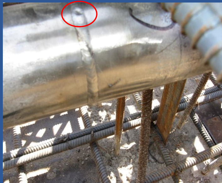
Не заваренный кратер на сварном шве аустенитной трубы
