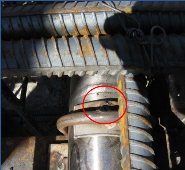
Брызги металла на сварном шве и околошовной зоне аустенитной трубы
