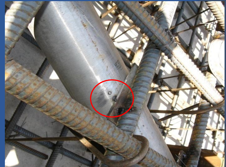
Повреждение аустенитной трубы брызгами металла
